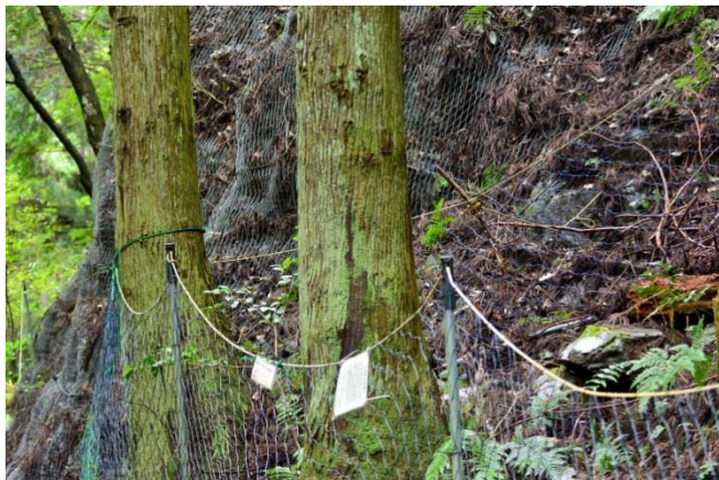
ポール損傷(画面中央奥)
