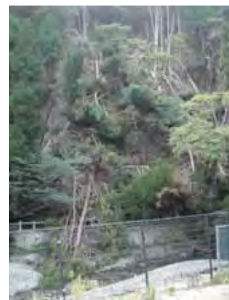
大日駐車場前 斜面の崩落
